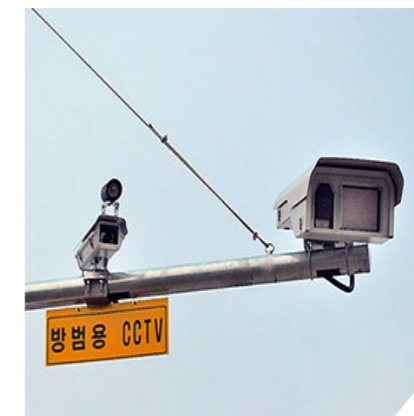
방범용 CCTV 전원관리, 모니터링
