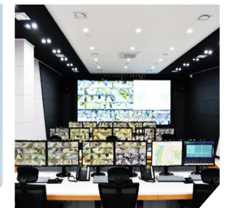
장비 전원 제어가 필요한 시설
